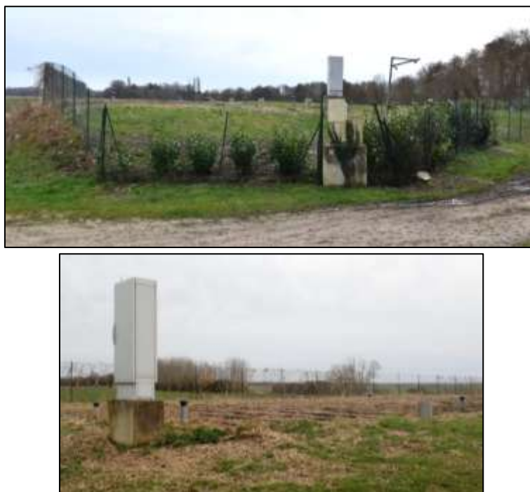
Photographie 10. Station d'épuration collectant les eaux des Bordes-Aumont (Mosaïque Environnement, 2024)
