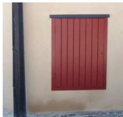
(8) Exemple de coffret technique encastré et fermé par un portillon constitué de lames de bois verticales assemblées.
