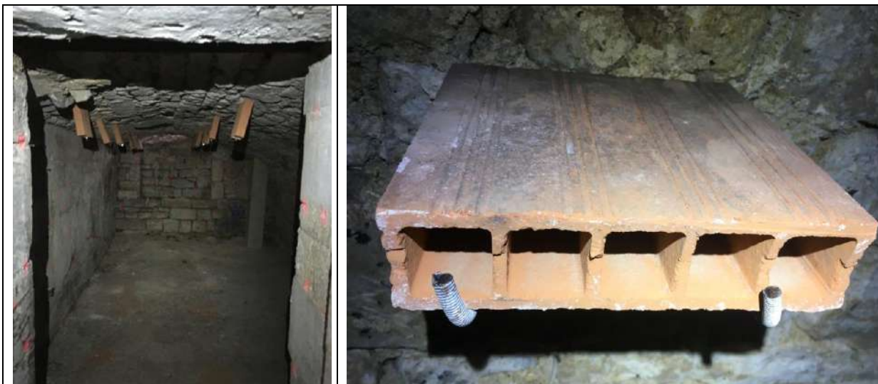
Illustration de l'installation de briques plâtrières au sein d'une cave avec plusieurs systèmes d'accroche selon l'orientation
