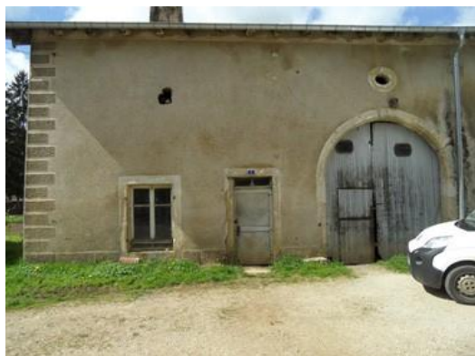
30. ARRONDI DE PORTE DE GRANGE AVEC PIERRES APPARENTES DES OUVERTURES ; ŒIL DE BŒUF
