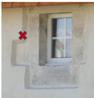
Enduits en surépaisseur interdits
