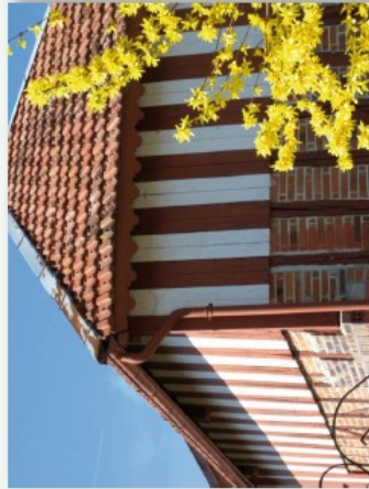
Baroage de planches peintes alternant le rouge et le blanc, s'accordant au pan de bois à remplissage de brique et à la tuile mécanique. Lusigny-sur-Barse
