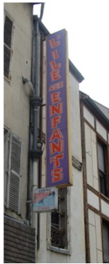
Enseigne non démontée dans les étages
