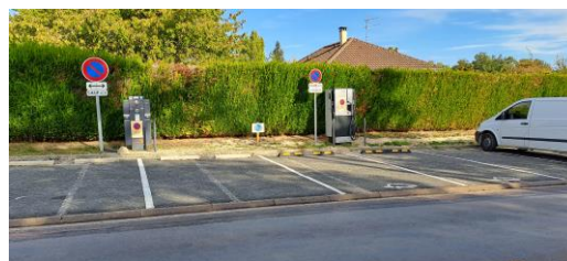
Photo 1. Bornes de recharge pour voiture électrique
