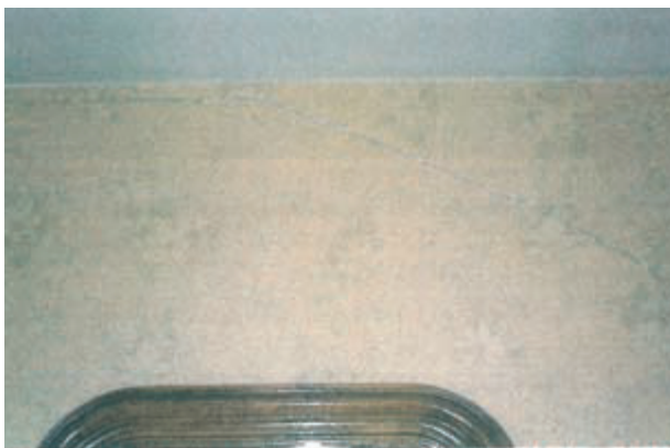
Fissuration intérieure, tapisserie déchirée - Maison André.
