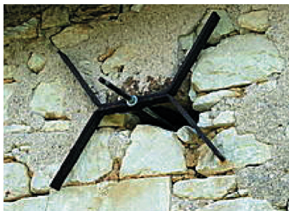
Figure 23 Exemple de chaînage apparent en façade (type croix de St-André) (Source Socabat)
