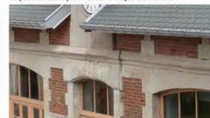
La peinture sur la pierre et sur la brique est interdite.
