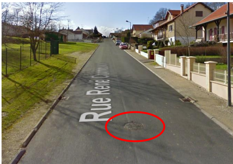
Figure 25 Regard rue Connesson présentant des infiltrations
