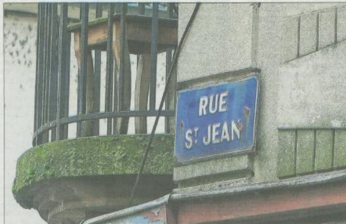
Dans le cadre de sa politique de réhabilitation du centre ancien, la Ville souhaite engager prochainement des travaux dans la rue Saint-Jean. Photo VM/Olivier JORBA
