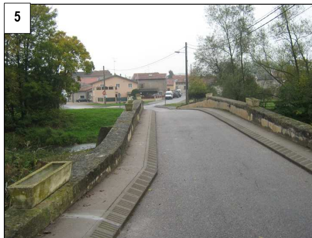
5 Pont sur le Sânon, trottoirs peu larges permettant difficilement un franchissement sécurisé pour les piétons.
