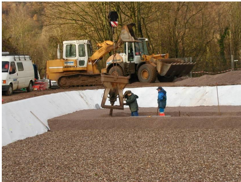
Phase de remplissage d'un filtre du premier étage à Arnville (54)
