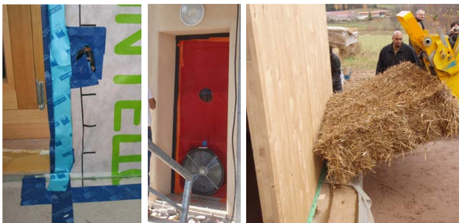
Exemple de mises en oeuvre et de systèmes visant la performance énergétique et la réduction des carbone : étanchéité à l'air, test d'étanchéité à l'air et construction bois isolée en bottes de paille (Gerbépaille - Le Toit Vosgien à Gerbépail).
