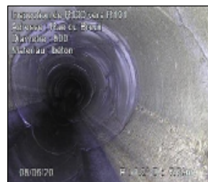
Fissure longitudinale – Rue du Breuil
