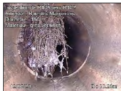
Obstruction partielle par radicelles – Rue des Marronniers
