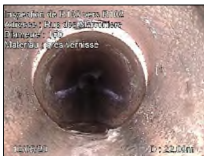
Emboîtement fortement désaxé horizontalement – Rue des Marronniers
