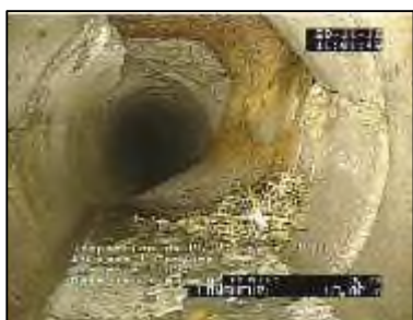
Effondrements – Rue de la Liez
