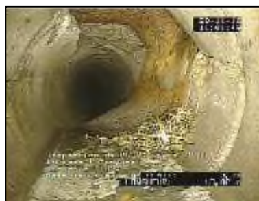
Effondrements – Rue de la Liez
