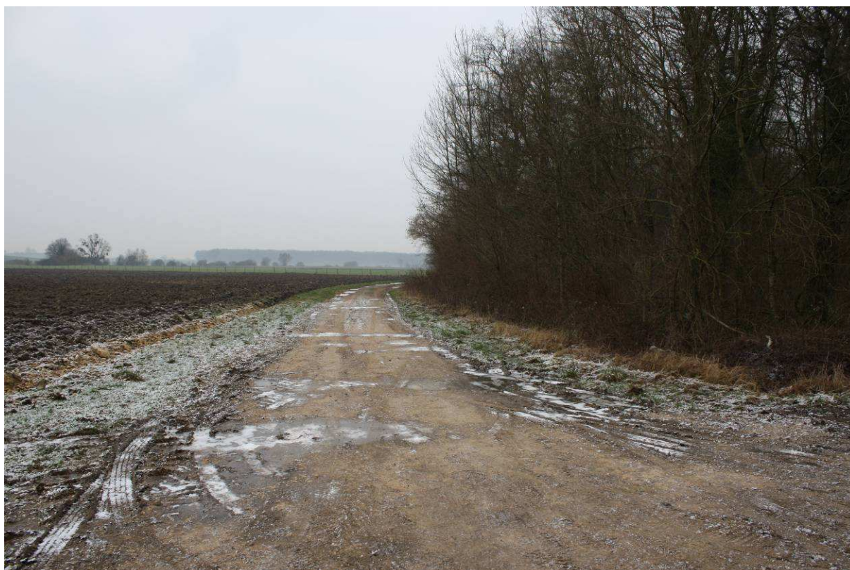
photo n°4 : chemin rural dit de la Plaine – chemin empierré en mauvais état
