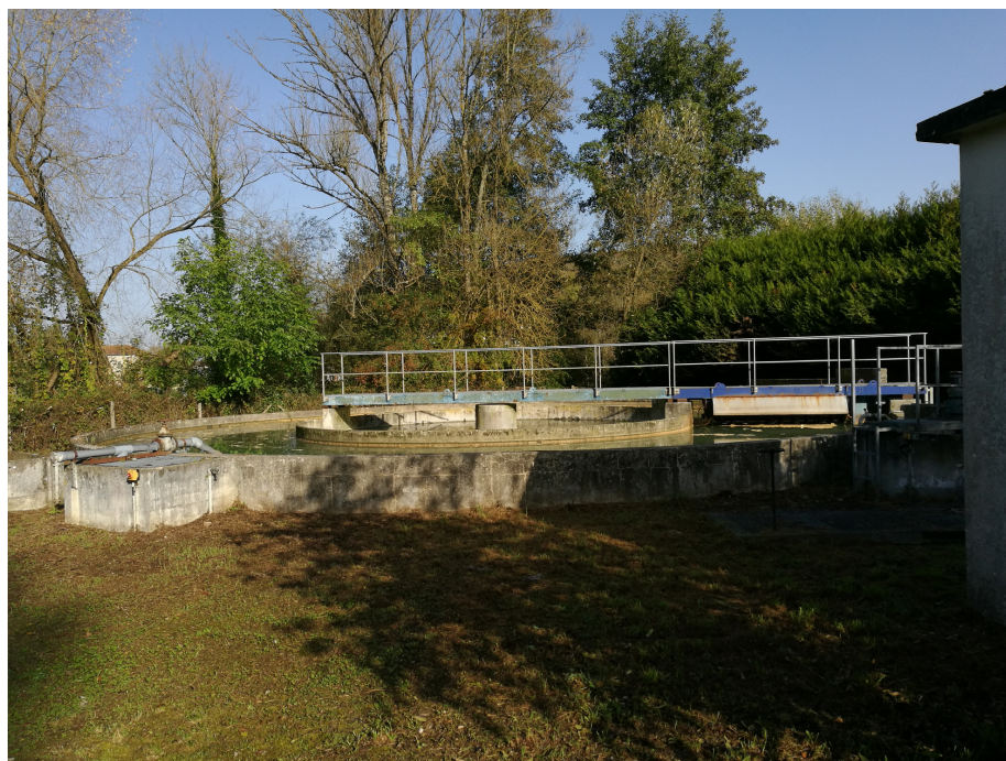
Bassin d'aération (zones aérobie et anaérobie)
