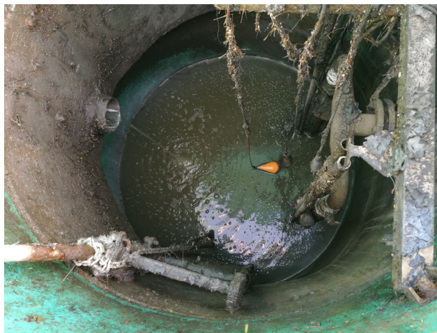
Bâche du poste de relevage des eaux brutes (traces importantes de mises en charge)
