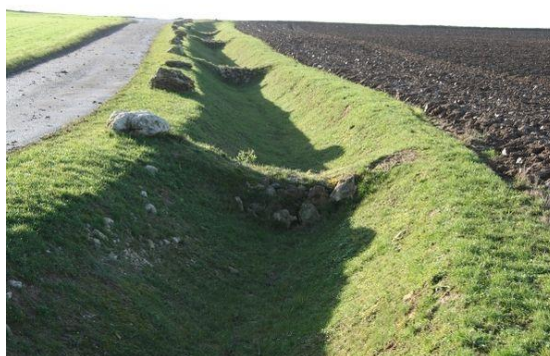
Photographie d'un fossé aménagé avec des redents.
