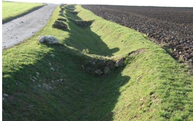
Photographie d'un fossé aménagé avec des redents.
