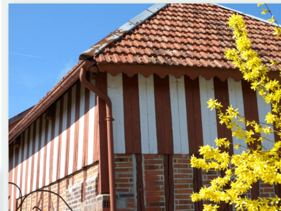
Bardage de planches peintes alternant le rouge et le blanc, s'accordant au pan de bois à remplissage de brique et à la tuile mécanique, Lusigny-sur-Barse
